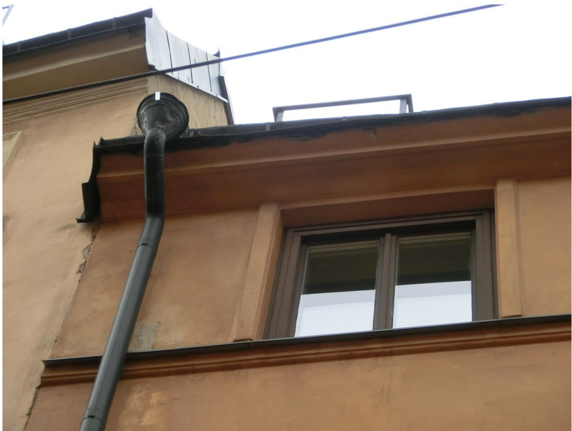
Lös puts under takfotslist under takplåten.
