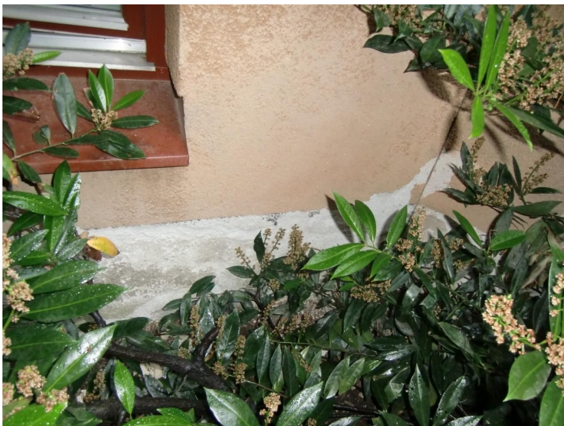
Delar av sockelputsens släpper.
